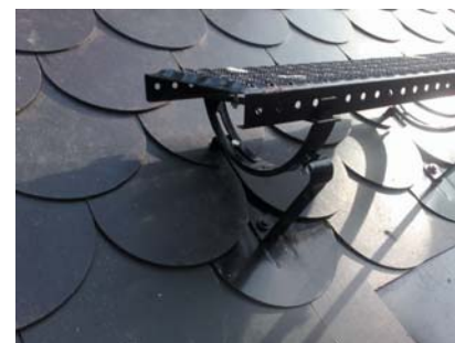
popis 3 Univerzální vlna č. 39 používaná pro stoupací plošinu č. 48 na hladké krytiny typu Cembrit
